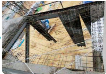
데크플레이트 붕괴 후
