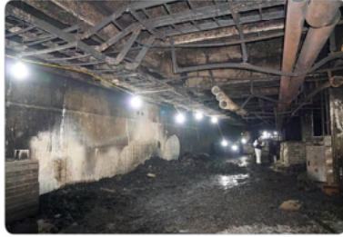
주상복합 신축공사 중 화재 ('18.6.26. 사망 3, 부상 37)
