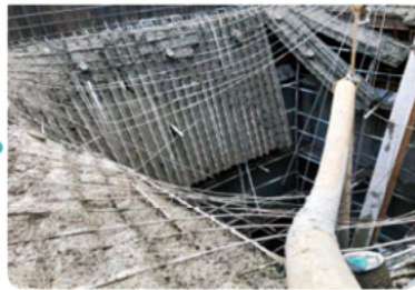
데크플레이트 붕괴 후
