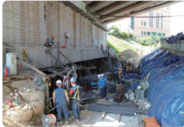
북선 전철 교량 하부 보강 중 LPG 폭발 ('16.6.1. 사망4, 부상 10)
