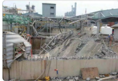
폐수 환경 설비 구축공사 중 폭발 ('15.7.3. 사망 6, 부상 1)
