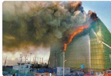
부산 냉동창고 신축공사 화재 ('98.10.29. 사망 27, 부상 16)
